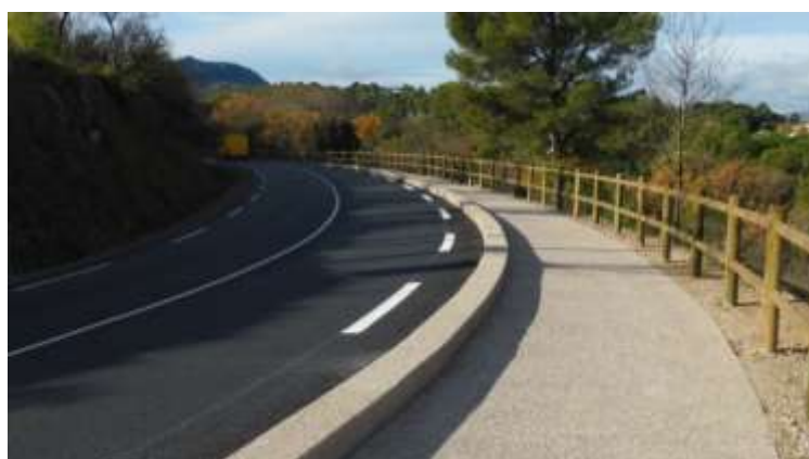
Réalisation de la 1ere tranche de la piste cyclable reliant Clermont l'Hérault au lac Eté-automne 2020
